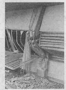
大分県中部地震(1975年)での柱のせん断破壊。帯筋の間隔が30センチで、現在の規定の10センチより広いことが原因(琉球大学工学部森下陽一教授提供)
