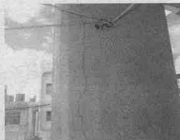
【写真1】RC造住宅の柱の縦ひび割れ（鉄筋が錆びて膨張したために、数ミリ幅のクラックが生じている）
