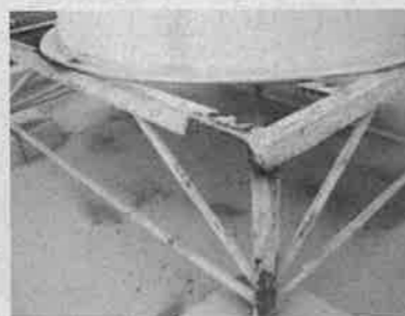
【写真2】地震や台風で飛んでしまいそうな屋上の水タンク（ボルトが細過ぎる、台からはみ出している、架台が腐食している）
